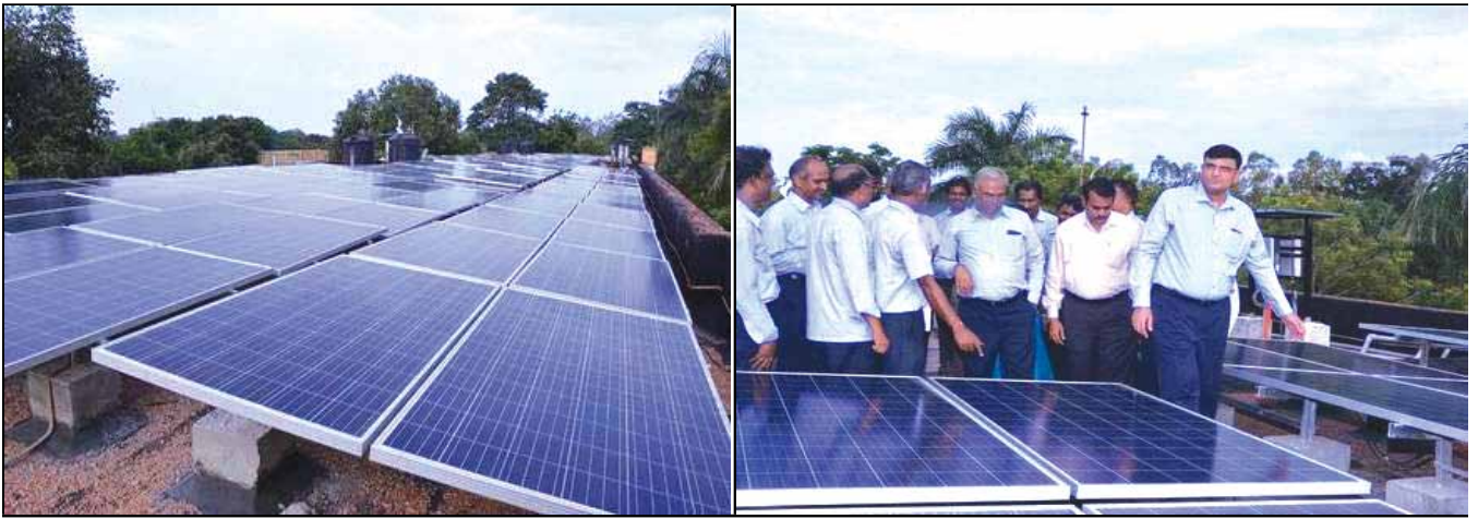
चित्र: नेयवेली, एनएलसीआईएल में आवासीय भवन पर रूफ टॉप सौर ऊर्जा पैनल
