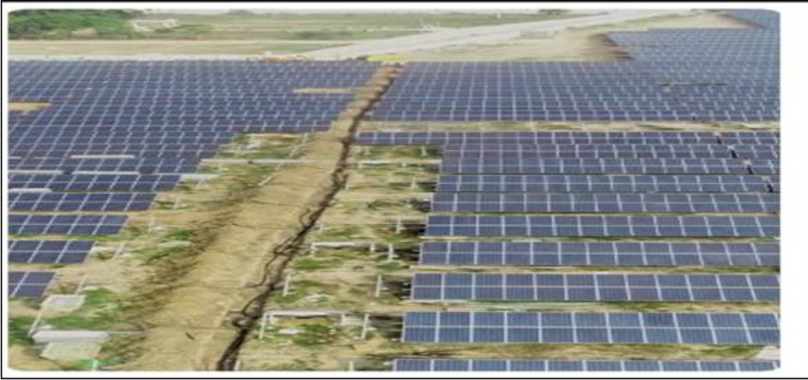
- एससीसीएल: मनुगुरु में सौर पावर प्लांट (30 एमडब्ल्यू)
